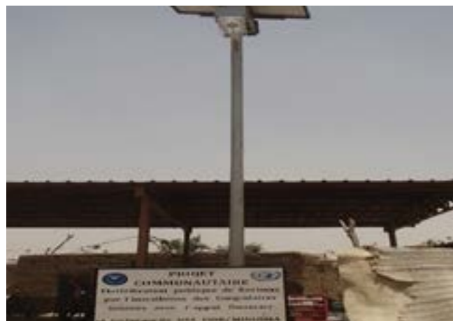
Système Solaire du Centre de Santé Communautaire Mondoro, Mopti, avril 2016
