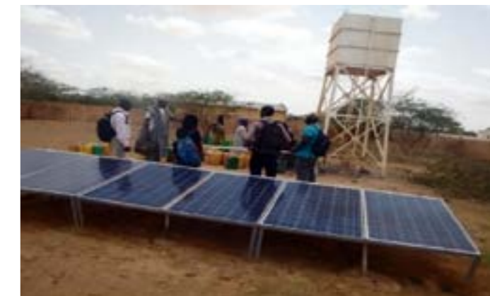
Système solaire du Centre de Santé Mondoro, Mopti, avril 2016
